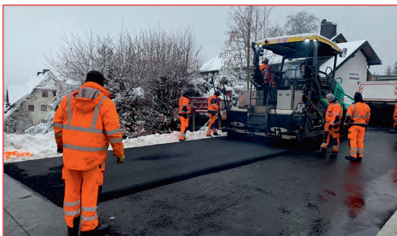
Erneuerung der Kreisstraße im Bereich Parkplatz Talstation Süd in und um Fleckl und Umbau Knotenpunkt mit der Ortsstraße „Vordergeiersberg“ (BT 4)
